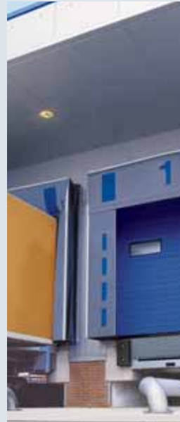
5 Equipements de quai
